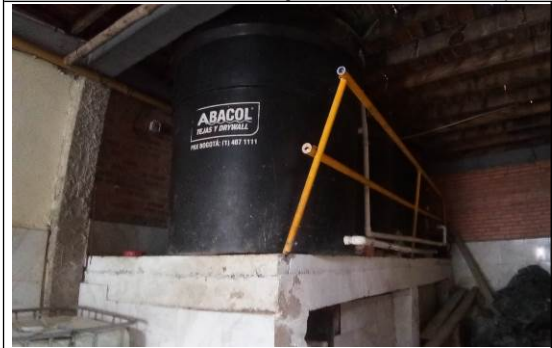
Foto No. 5 Tanques para el tratamiento de ARnD.
